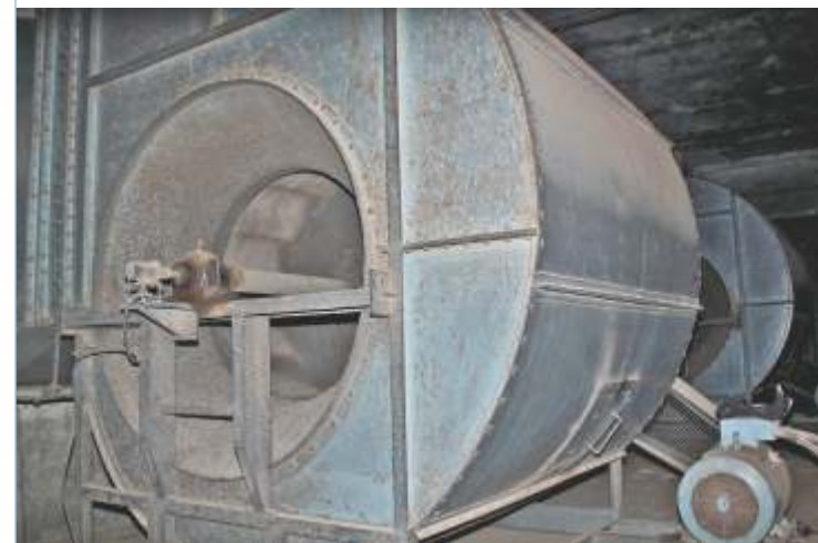
Ventilation fan for Karbude tunnel
